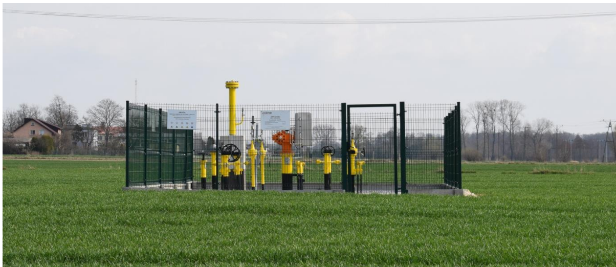
Fot. 14. Infrastruktura gazociągu wysokiego ciśnienia 2xDN 500 PN 6,3 MPa relacji Rembelszczyzna-Włocławek Autor: Piotr Fogel
