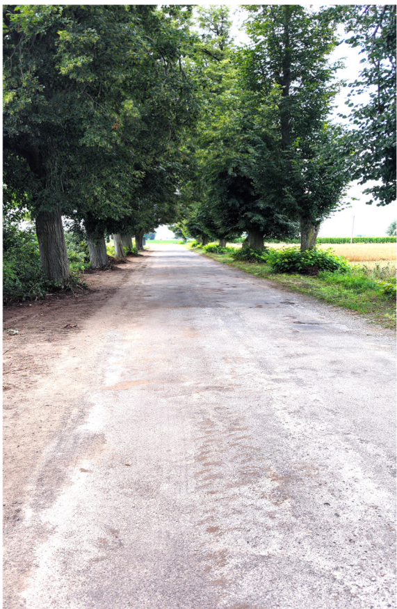
Fot. 82. Droga w złym stanie – Pluskocin.
