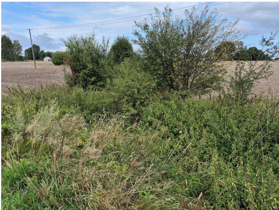
Fot. 78. Rów melioracyjny zarośnięty, w złym stanie – miejscowość Wilamowice.
