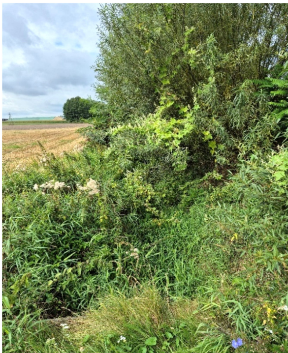
Fot. 61. Rów w złym stanie w miejscowości Wilamowice.
